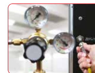
Controllo pressioni ad azoto
